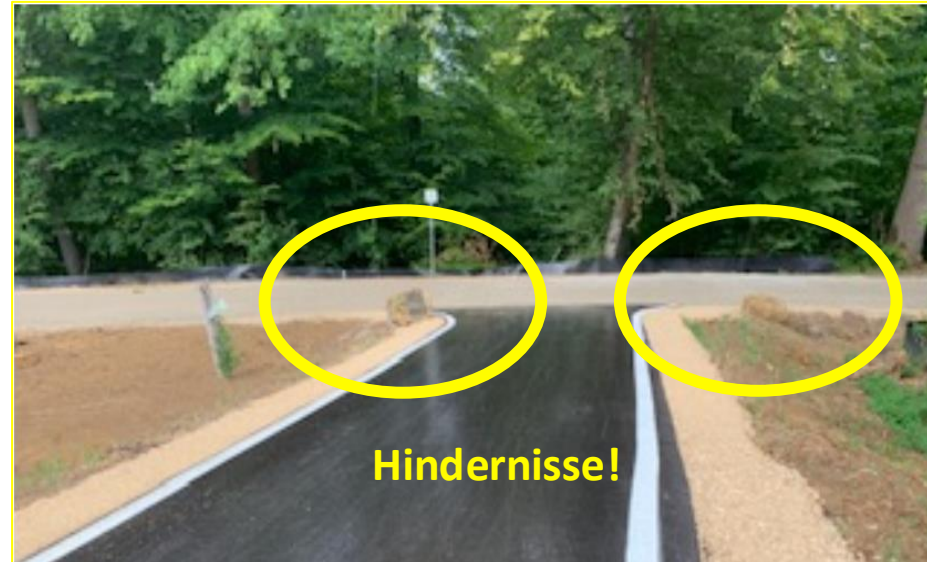
Audit: „Geh- und Radweg L 1201 zwischen Aichschieß und der Deponie Weißer Stein“ (Vor Verkehrsfreigabe)
